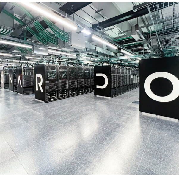
LE REALIZZAZIONI DI NESITE AL TECNOPOLO DI BOLOGNA
