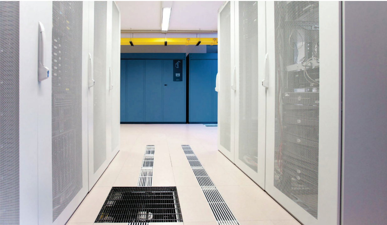
UN ESEMPIO DELLE PAVIMENTAZIONI DEDICATE AL DATA CENTER
